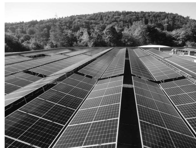
Anlage auf der neuen Dreifachturnhalle
