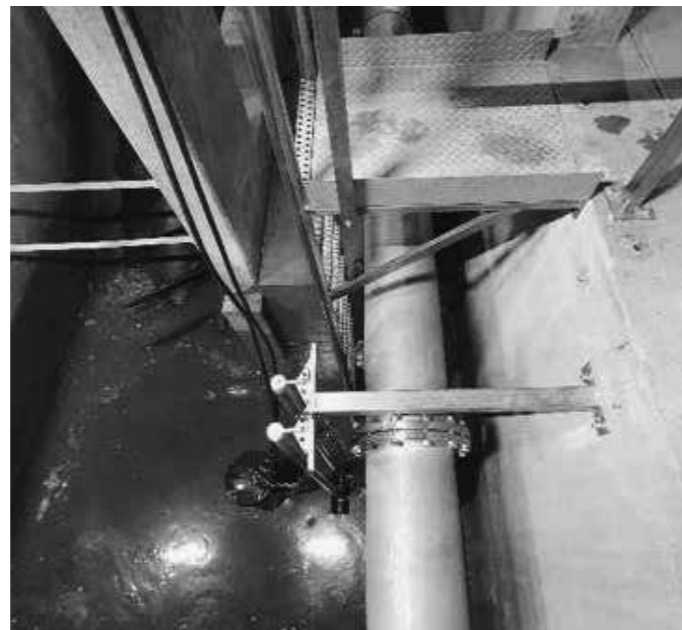
Blick in den Pumpenschacht des Pumpwerks Schiffflände
