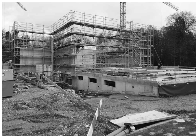
Die Holzheizzentrale Rüchi nahm Anfang 2021 ihren Betrieb auf.
